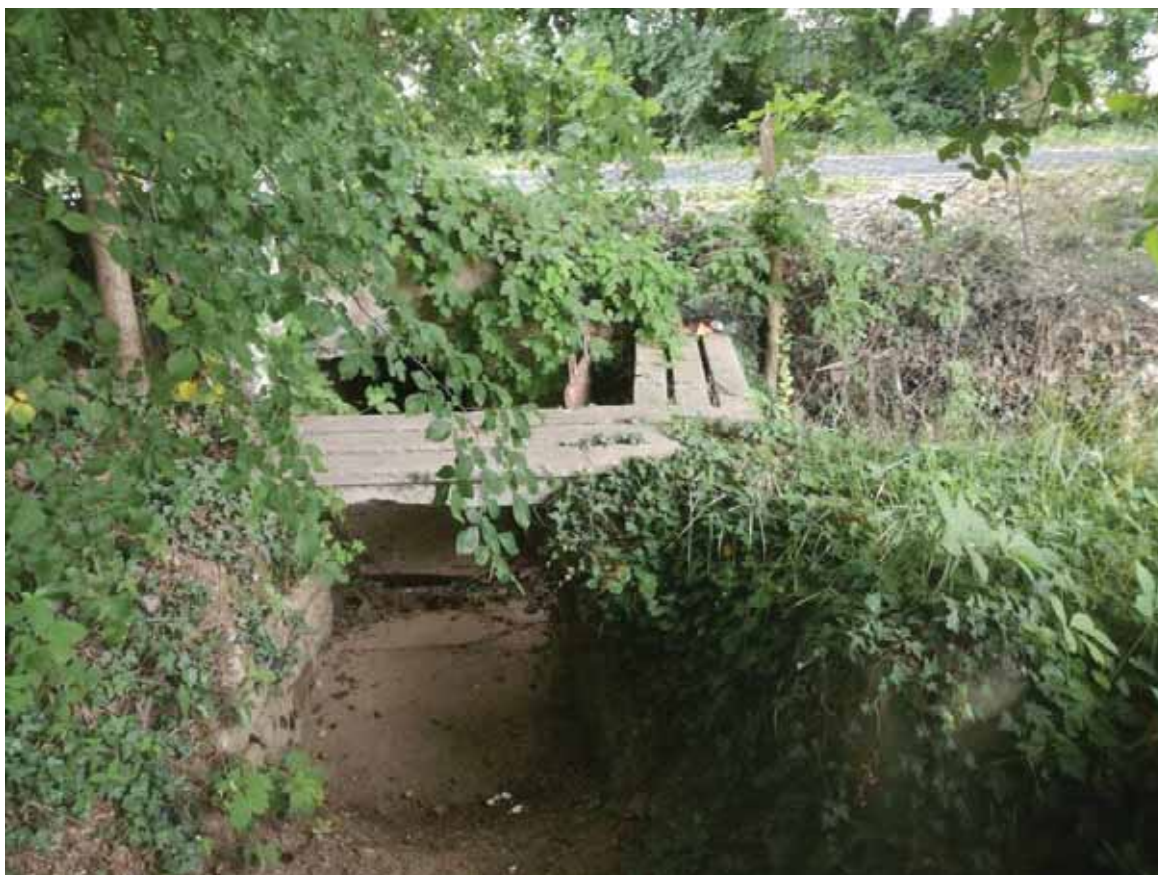
Foto_2: particolare del sistema di paratoie sulla Roggia Caionvica che da Via Buffalora si dirama verso Ovest
