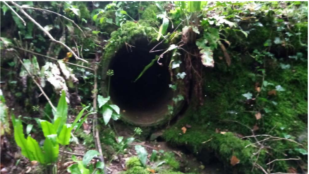
Figura 18: Tubo di scolo dell'area di deposito a monte.
