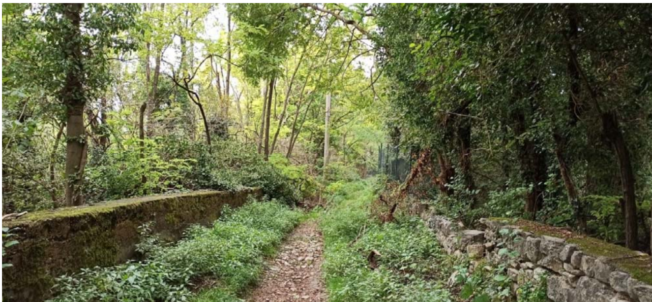
Figura 16: tratto terminale dell'area di intervento dove l'altezza dei muretti è ridotta. Si notano le cattive condizioni delle murature a secco.
