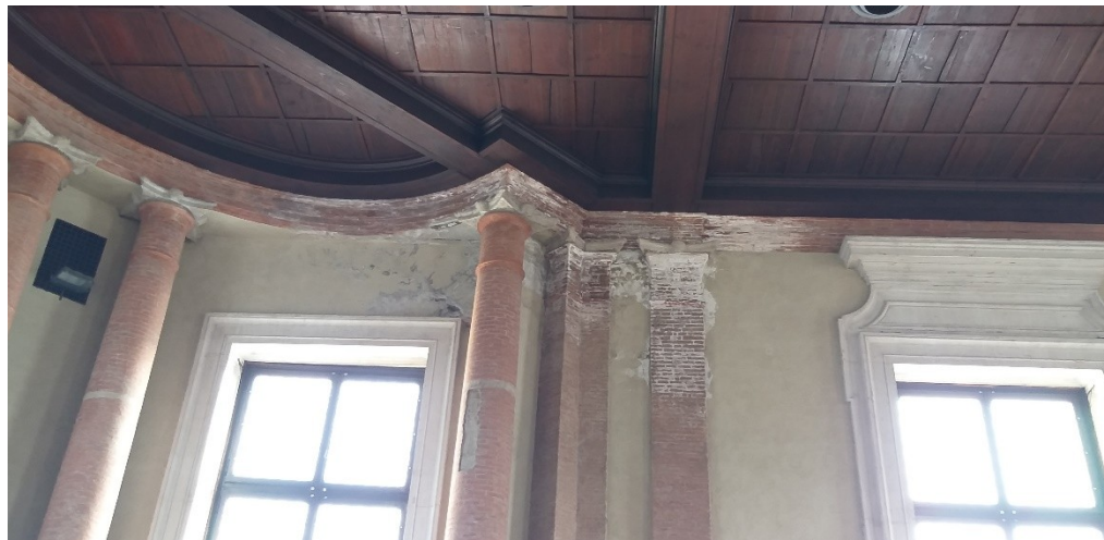
DEGRADO INTERNO SALONE
