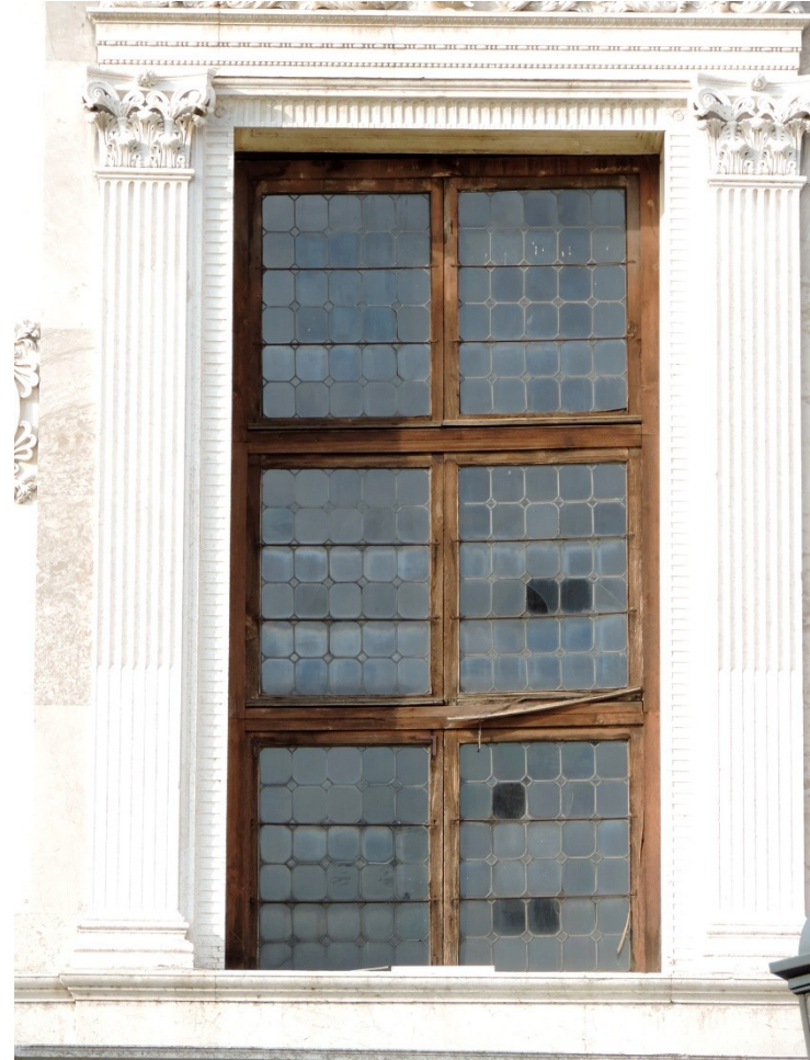
SERRAMENTO TIPO - DEGRADO
