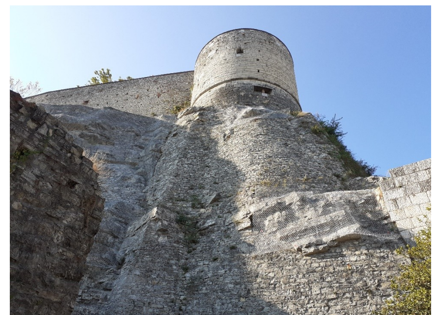
POST INTERVENTO di messa in sicurezza delle pareti rocciose con rivestimento con rete metallica in aderenza e rafforzamento corticale
