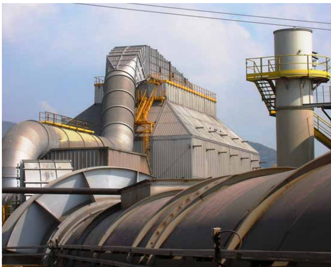
Impianti a presidio delle emissioni in aria
