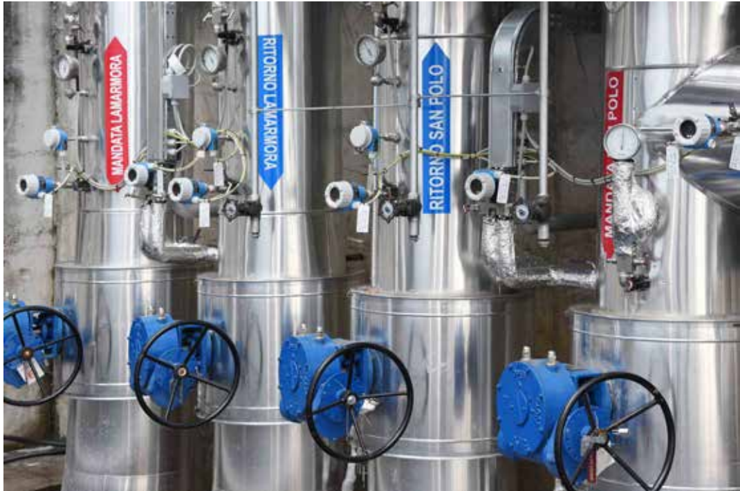
Particolare dell'impianto recupero calore
