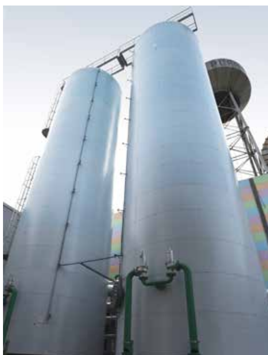
Serbatoi di accumulo acqua a servizio dell'impianto di recupero calore
