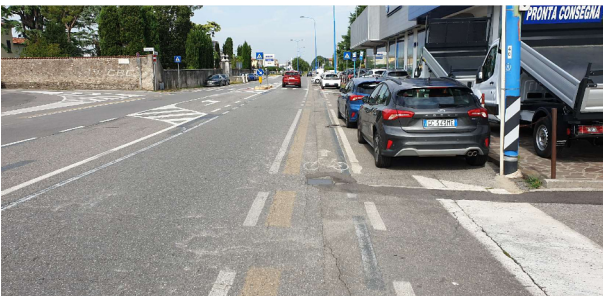
7. Cattivo stato della pavimentazione e caditoie non a filo dell'asfalto.
