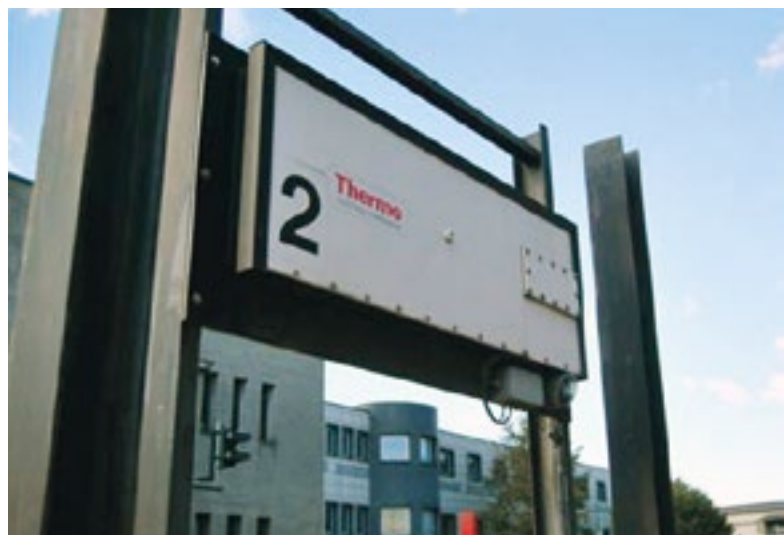
Rilevatori radioattività ingresso
