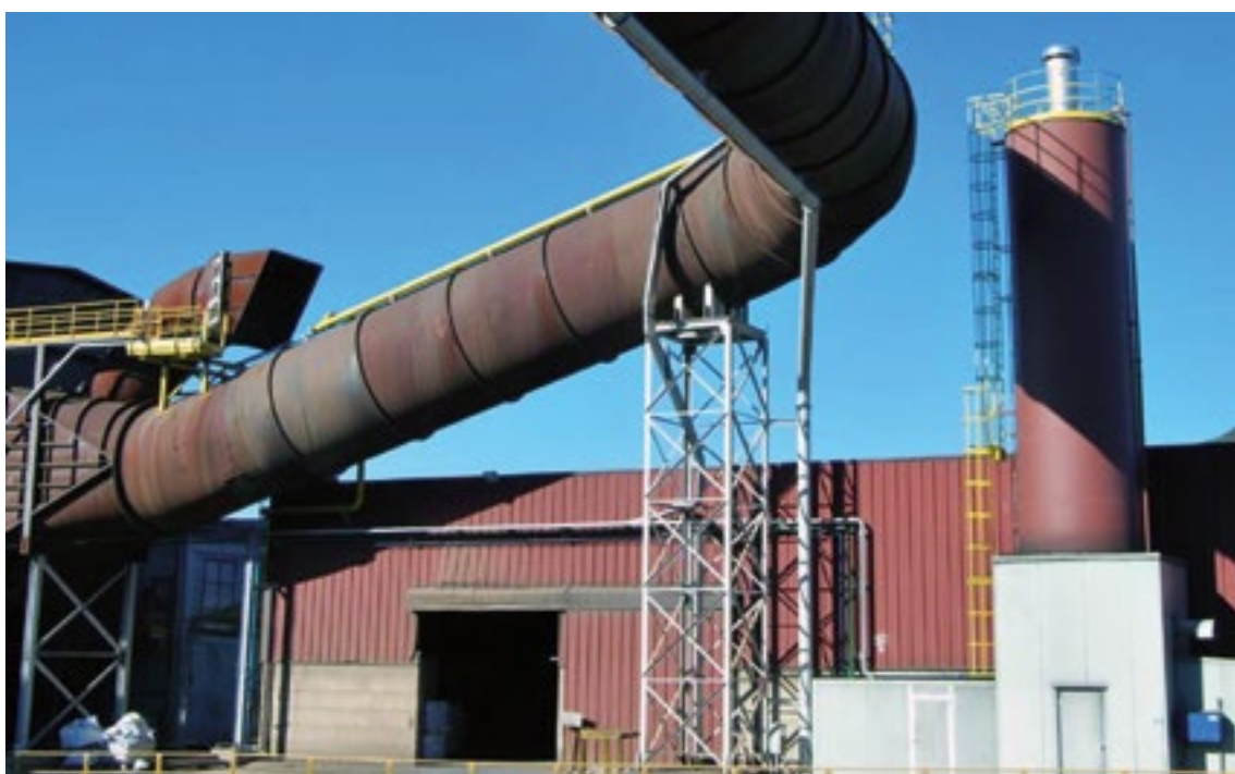
IMPIANTO A CARBONI ATTIVI
