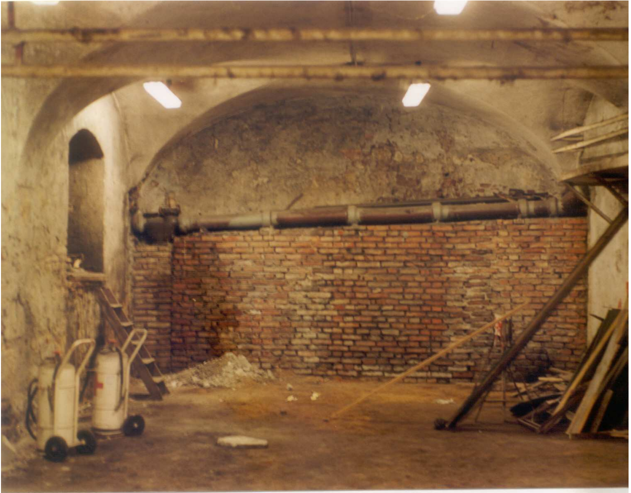
5. Immagine esplicativa dello stato di abbandono, e di preoccupante degrado, che caratterizza gli spazi del piano interrato. Il progetto ne prevede il completo risanamento per un riuso a magazzino librario.
